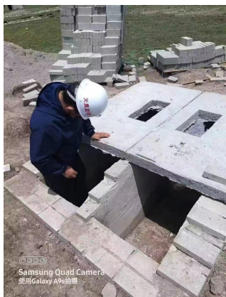
贮粪池、蹲台板
